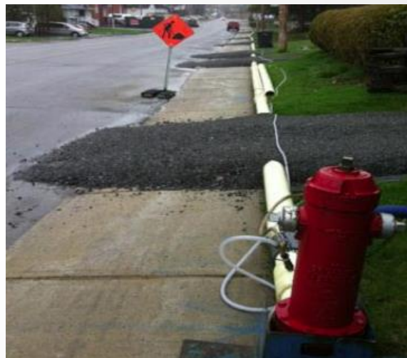
Réseau d'aqueduc temporaire
