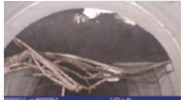
Racine qui s'incruste dans les conduits
